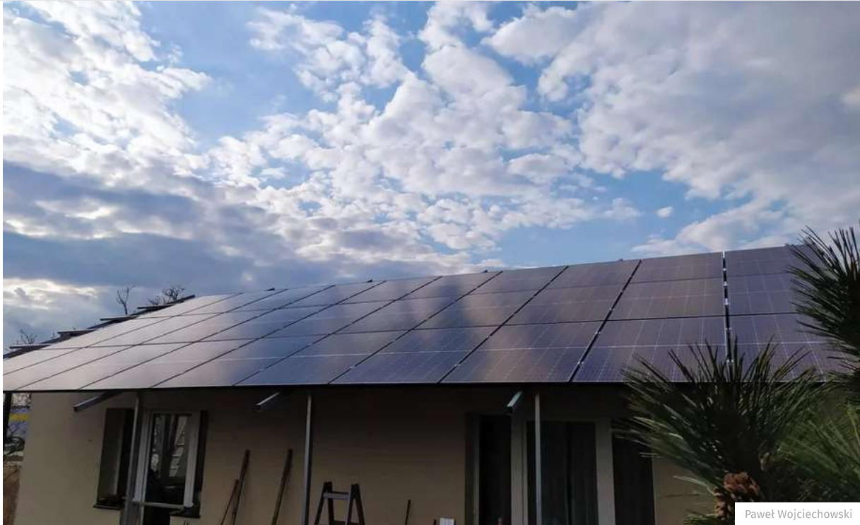
Pierwsza część instalacji fotowoltaicznej Pawła Wojciechowskiego
